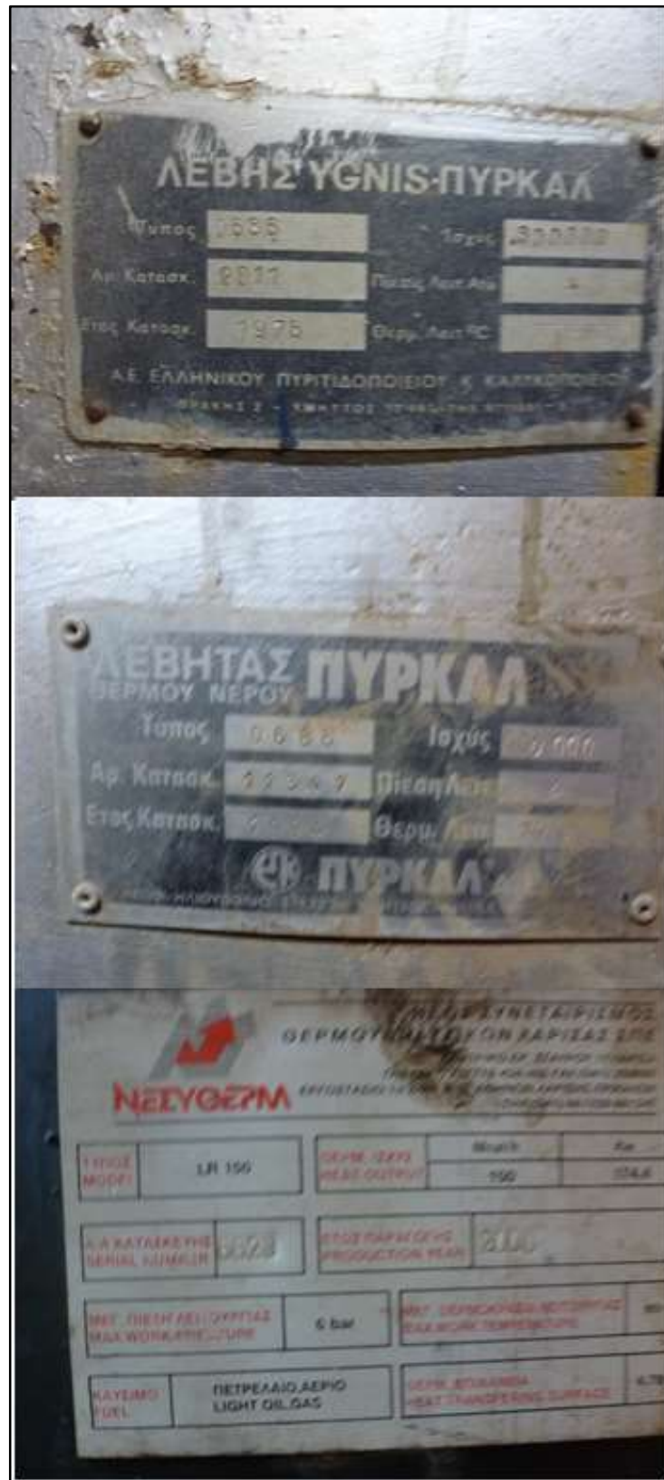
Εικόνα 3.2.1. Λέβητες 1,2,3 στο κεντρικό λεβητοστάσιο του κολυμβητηρίου
