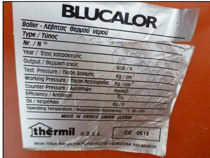
Εικόνα 3.2.2. Λέβητας 4 στο μικρό λεβητοστάσιο του κολυμβητηρίου
