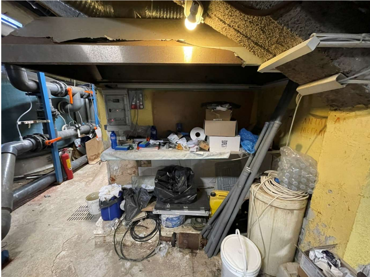
Εικόνα 4.3.5 Θέση εγκατάστασης νέου πίνακα ΧΤ (2/2)
