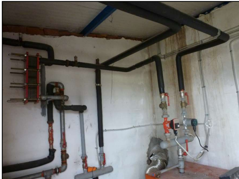
Εικόνα 3.2.8. Δίκτυο διανομής λεβητοστασίου αποδυτηρίων μικρής πισίνας
