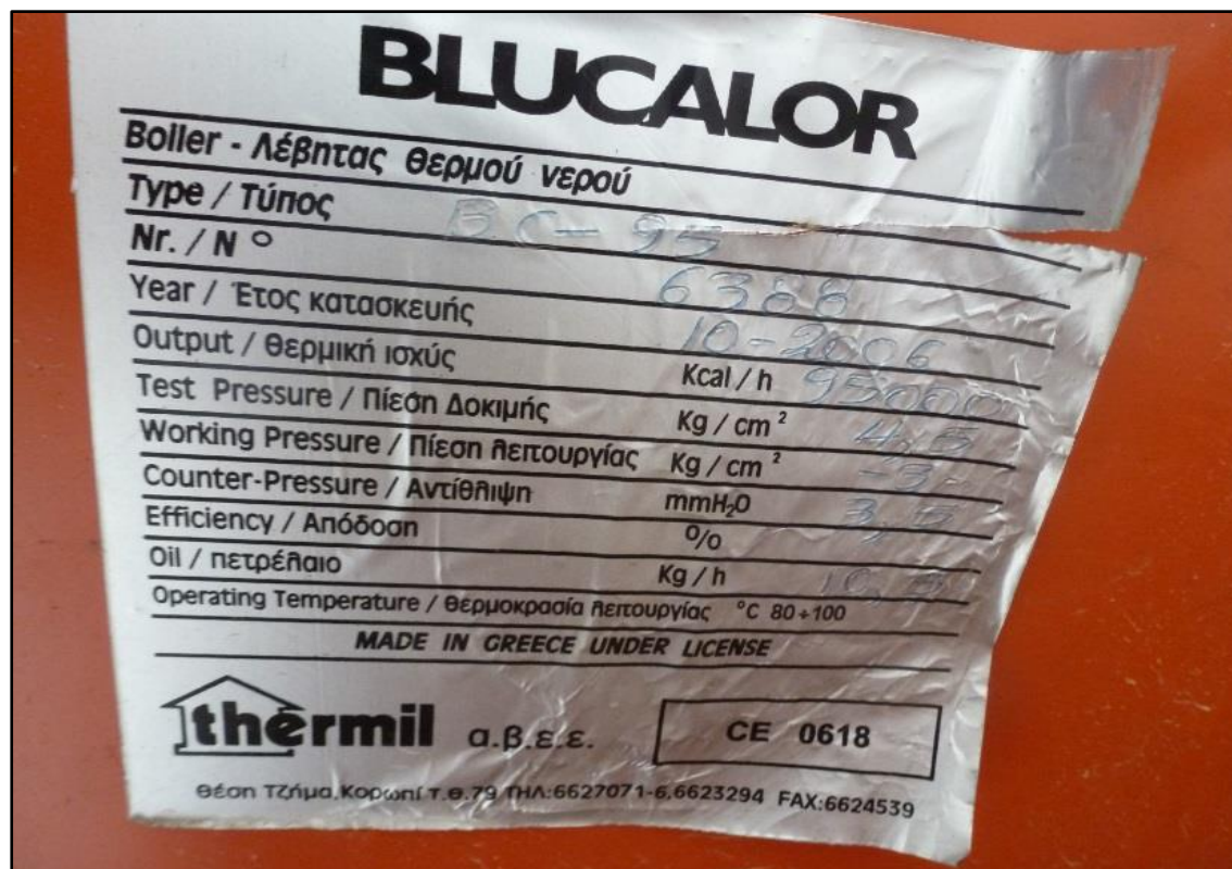
Εικόνα 3.3.4 Λέβητας 4 στο μικρό λεβητοστάσιο του κολυμβητηρίου
