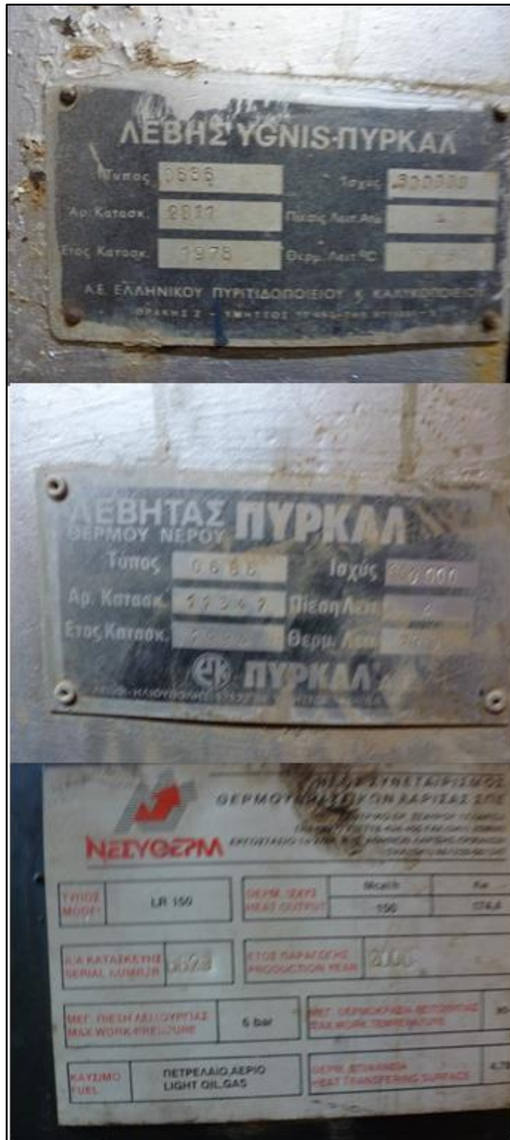
Εικόνα 3.3.3 Λέβητες 1,2,3 στο κεντρικό λεβητοστάσιο του κολυμβητηρίου
