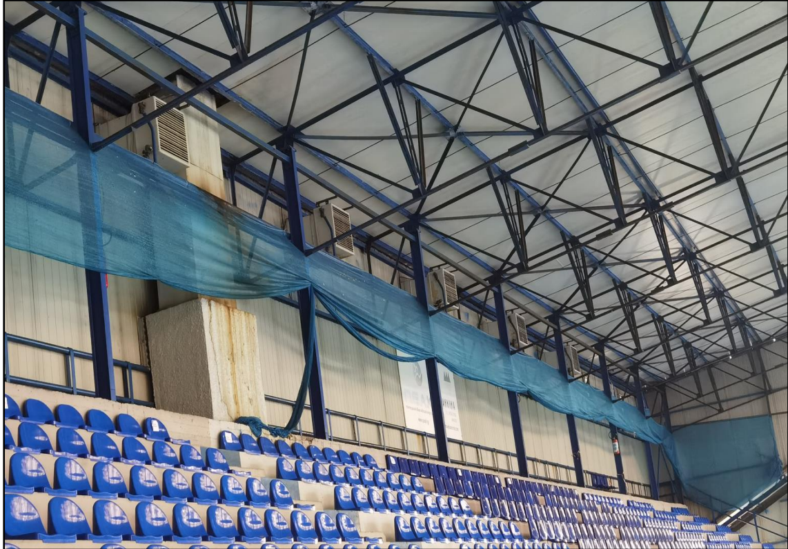
Εικόνα 3.3.11 Επίτοιχα αερόθερμα εισαγωγής νωπού φρέσκου αέρα στην μεριά των κερκίδων
