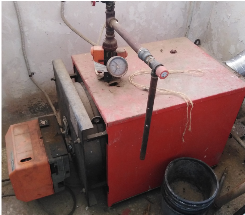
Εικόνα 2: Λέβητες θερμού νερού
