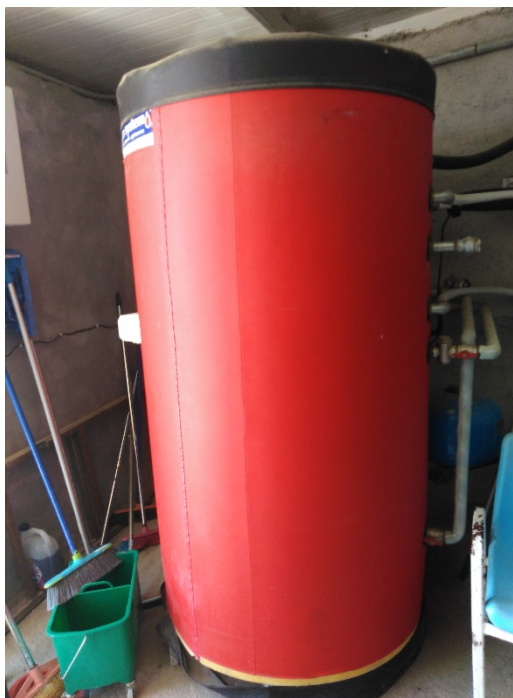
Εικόνα 5: Boiler αποδυτηρίων ποδοσφαίρου
