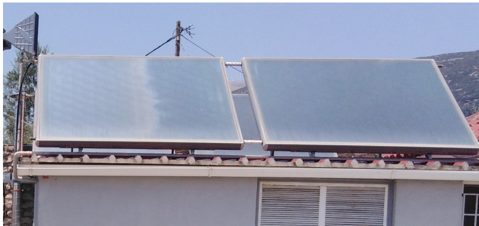
Εικόνα 6: Ηλιακοί για τη θέρμανση των ΖΝΧ αποδυτηρίων
