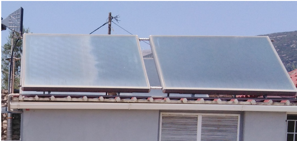
Εικόνα 6: Ηλιακοί για τη θέρμανση των ΖΝΧ αποδυτηρίων
