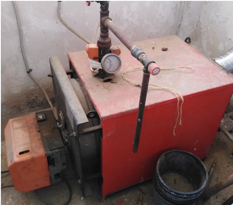
Εικόνα 2: Λέβητες θερμού νερού
