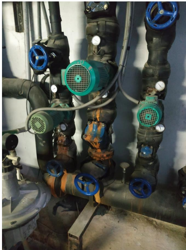
Κεντρικός Διανομέας Θέρμανσης των Χώρων
