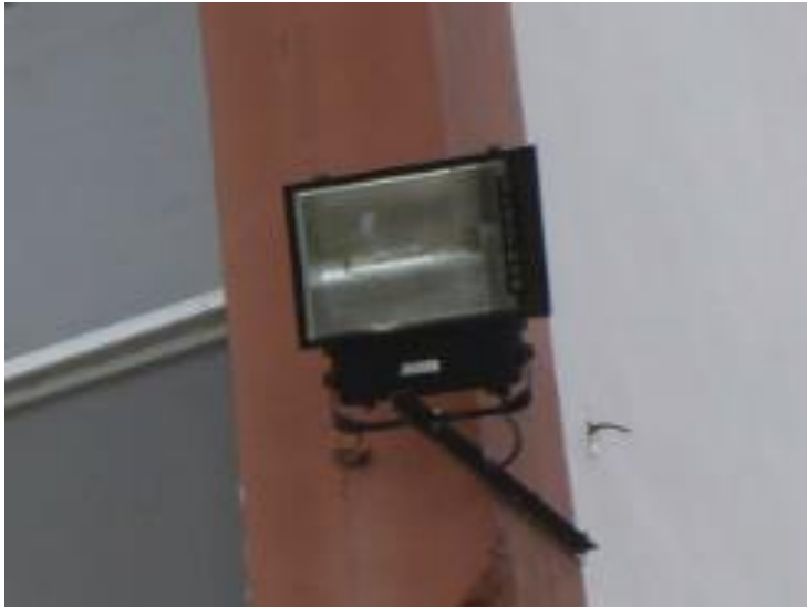
Εικόνα 6.3. Προβολείς εξωτερικού φωτισμού 150W
