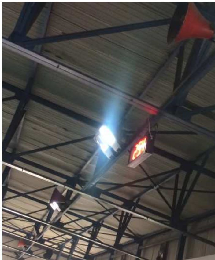
Εικόνα 6.4. Προβολείς πισίνας 250W
