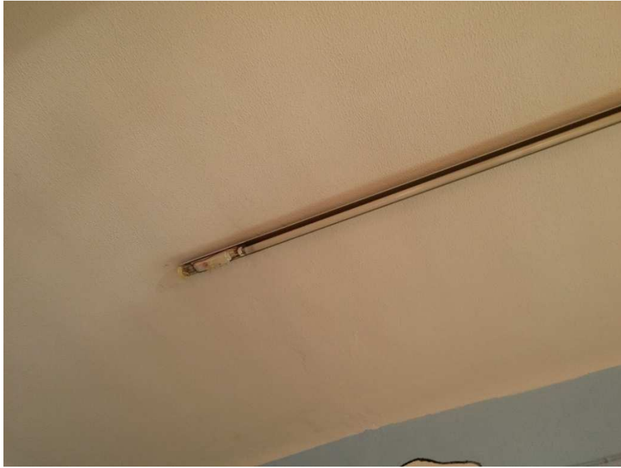
Εικόνα 6.1. Λαμπτήρες φθορισμού 1x36W (Αίθουσα αναμονής)
