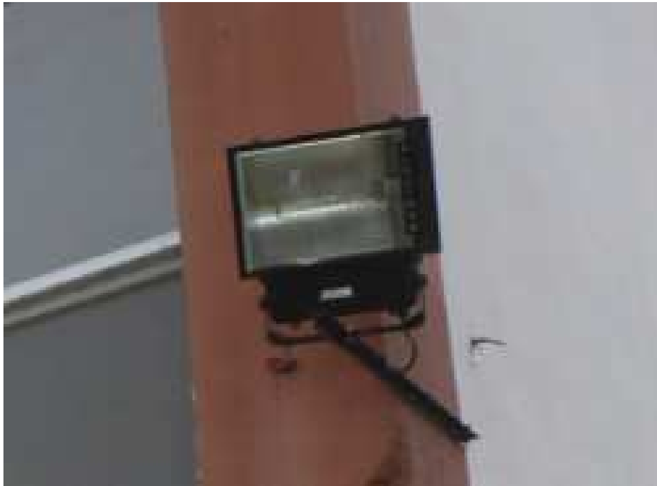
Εικόνα 6.3. Προβολείς εξωτερικού φωτισμού 150W
